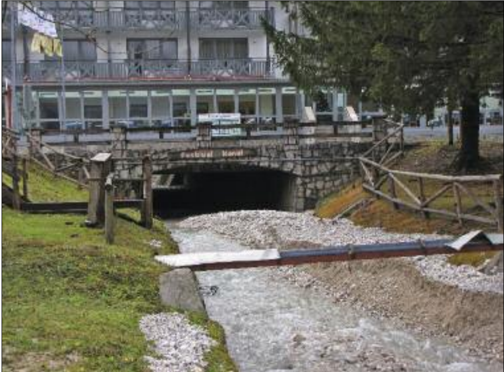
Slika 8: Neodgovorno je »stiskanje« hudournikov v ozke umetne struge, še bolj pa postavljanje objektov prek vodotokov. Primer prepusta za hudournik pod Hotelom Jezero v Bohinju. Hudournik je ob obilnih padavinah konec decembra 2009 pod hotelom prenašal večje količine plavja.
