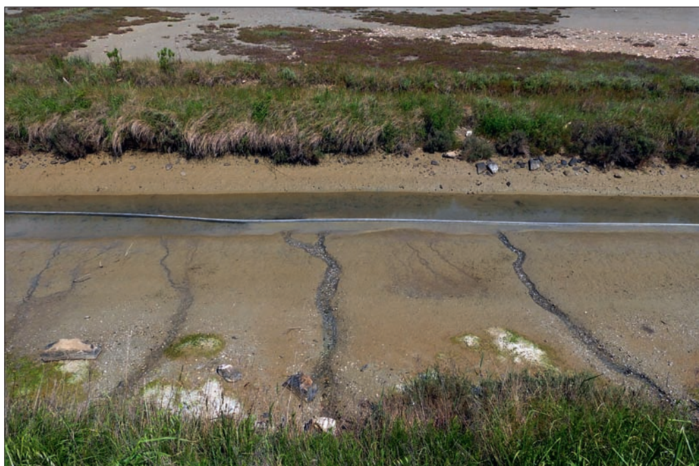
Slika 5: Struge puščajoče vode skozi razpoke imenovane gattolare v nasipu ob kanalu Grande.
