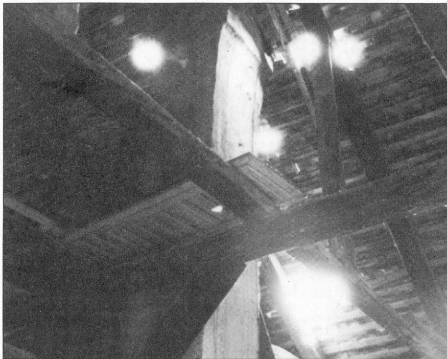
Slika 4. Pogled na poškodovano streho. Odlomljeni kosi dimnika so razbili strešno kritino. (Foto: P. Sinčič)
