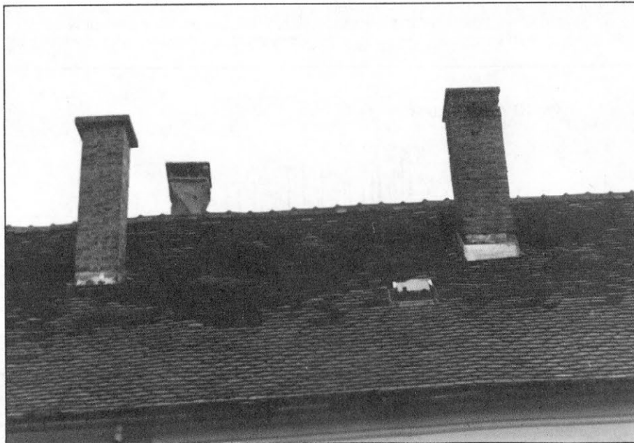
Slika 3. Poškodovani dimnik v »stari lekarni« v Brežicah. (Foto: P. Sinčič)
