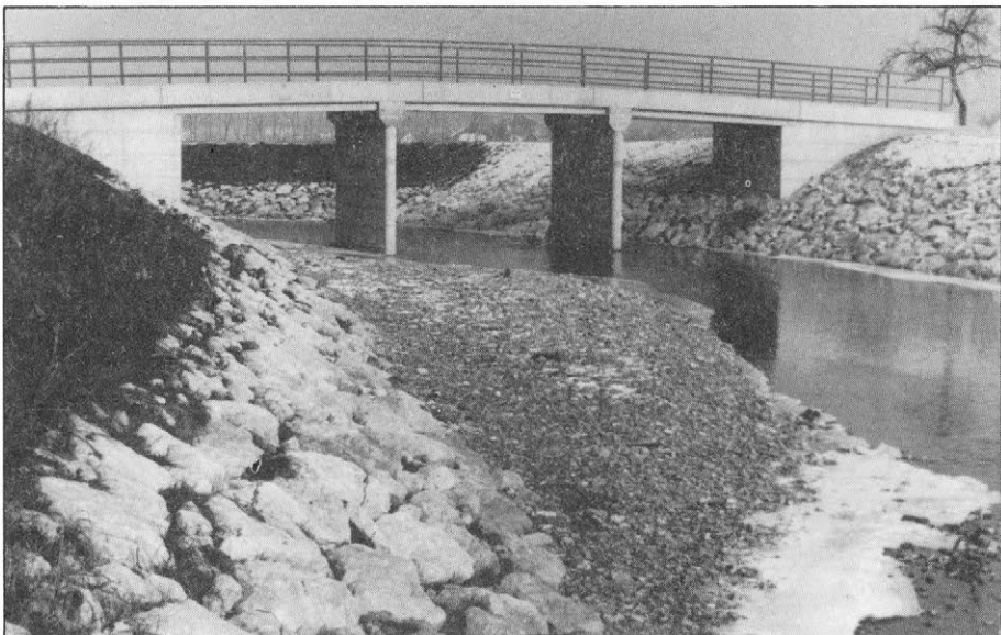
Slika 3. V letu 1991 zgrajen most prek regulirane Hudinje pri Škofji vasi. Pod mostom v zatišni legi je nastalo prodišče, ki zmanjšuje pretočno sposobnost struge. (Foto: M. Natek)
