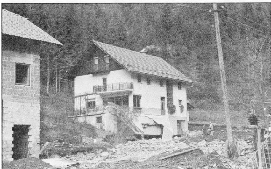
Slika 14. Hudourniški Krupah je v Ljubenskih Rastkah močno poškodoval novo Lojenovo hišo; spodkopal ji je del temeljev in zrušil balkon.
