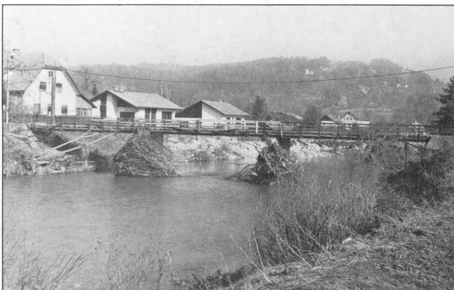
Slika 23. Sledi po visokovodnem valu Savinje na ločkem mostu v Mozirju, ko je voda drla čezenj in ga delno poškodovala.
