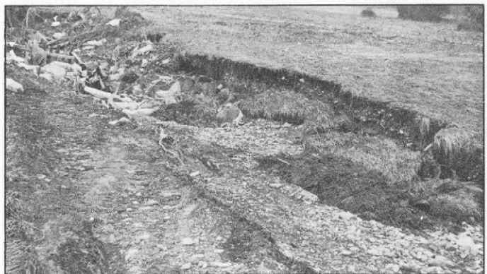
Slika 8. Poljski kolovoz med grobeljskim mostom in Dobrtešo vasjo je povodenj spremenila v pravo hudourniško (erozijsko) strugo (Foto M. Natek).
