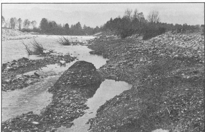
Slika 10. Levi breg Savinje na ločniški gmajni. Narasla voda je na več krajih poškodovala strugo in odnesla varovalni nasip (Foto M. Natek).
