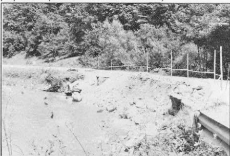
Slika 4. Poškodovana cesta med Podsredo in Zagajem; zaradi visoke vode Bistrice, julija 1989. (Foto: Marko Kolbezen)
