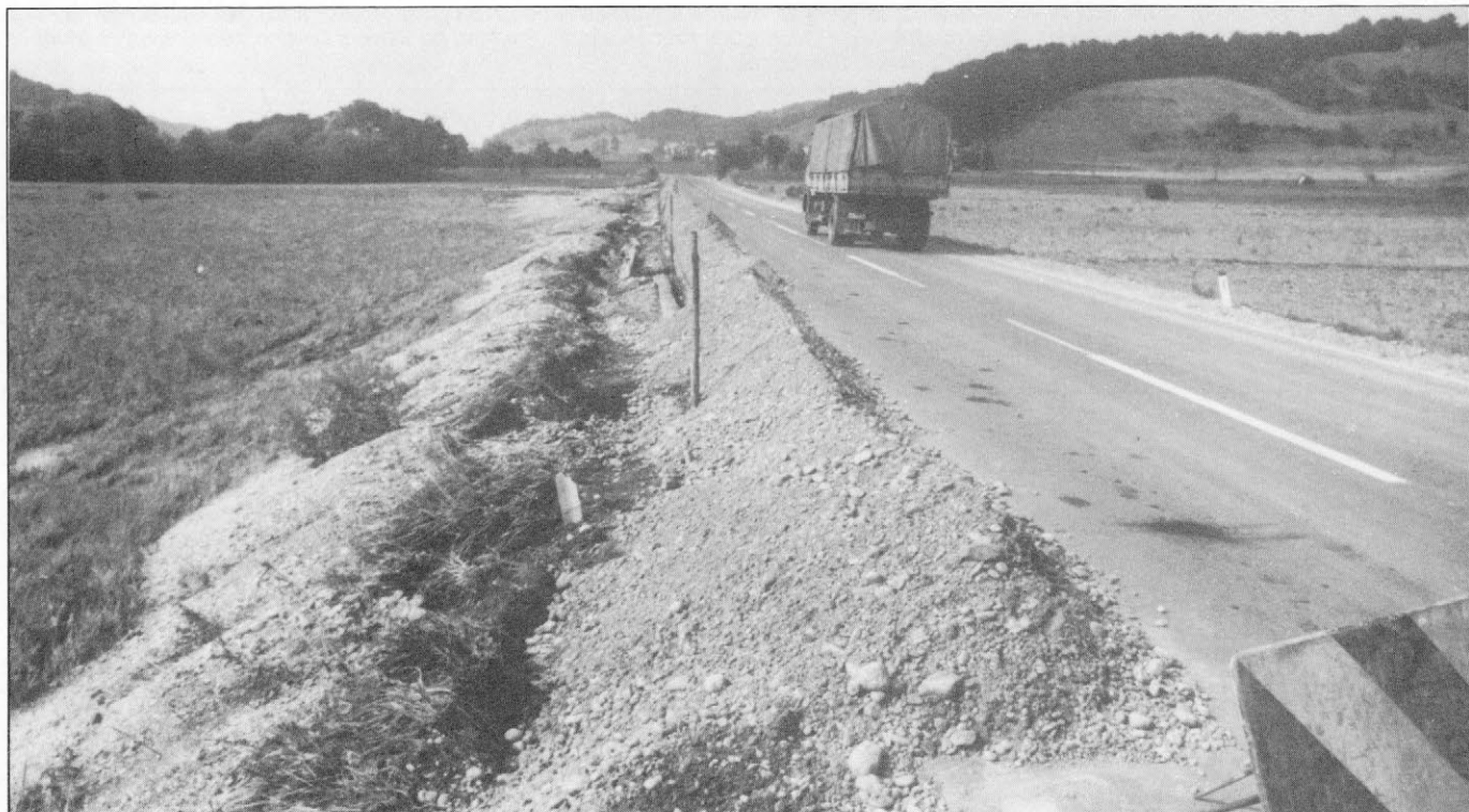
Visoka voda Dravinje je poškodovala cesto Maribor–Zagreb.
