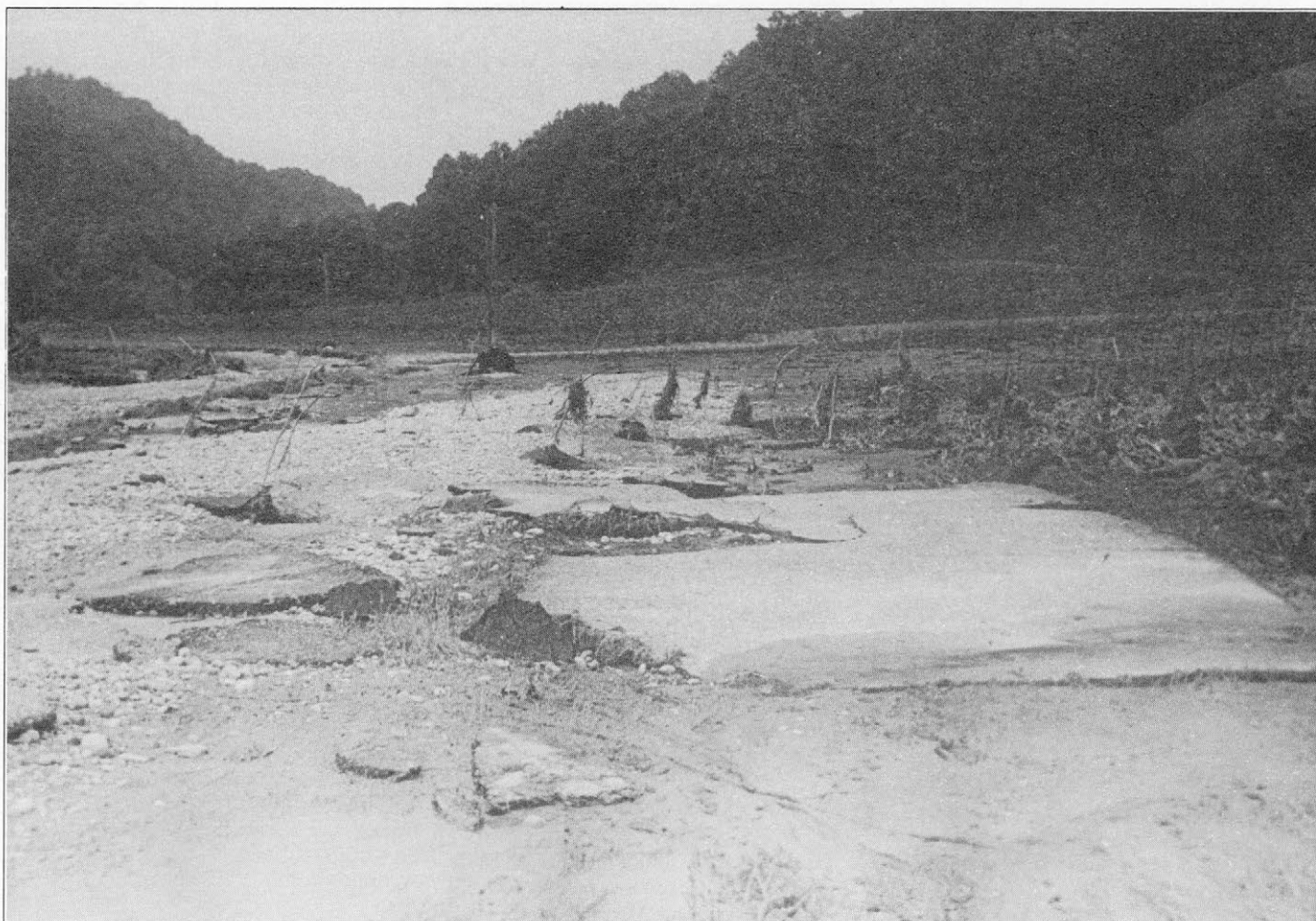
Slika 3. Uničena lokalna cesta z asfaltno prevleko v naselju Naraplje.
