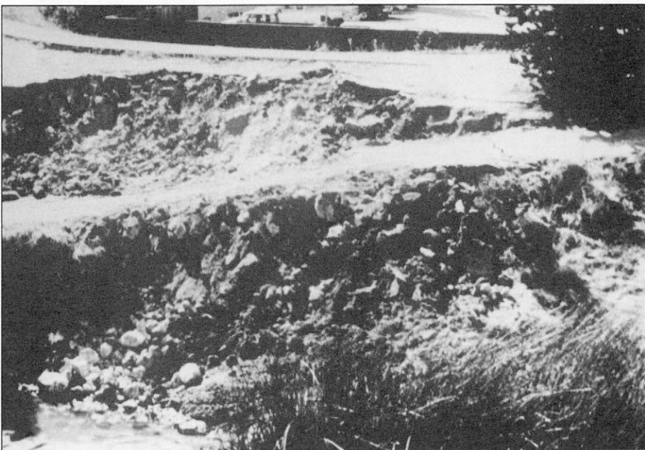
Slika 11. Santa Cruz – porušitev nasipa na sprehajalni poti.
