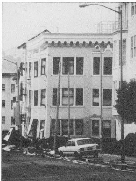
Slika 5. Marina – porušitev hiše lesene konstrukcije.
