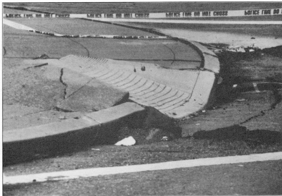
Slika 10. Marina – deformacija asfaltne prevleke pločnika.
