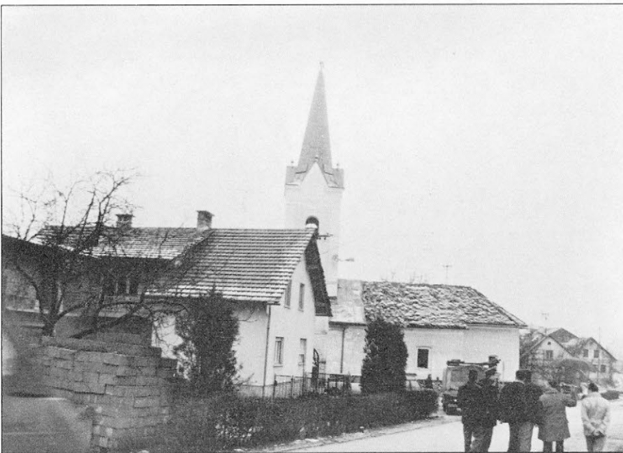
Slika 2. Pogled na cerkev sv. Simona in Jude v Pijavi Gorici, ki jo je 26. 2. 1989 poškodovala strela (foto UNZ Ljubljana mesto).
