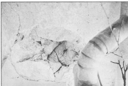
Slika 5. Strela je prebila skoraj meter debel zid cerkve in razrahljala večje kamnite bloke, iz katerih je zid zgrajen (foto R. Vidrih).
