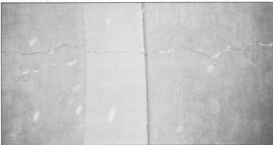
Slika 8. Poškodovana je bila tudi notranjost cerkve. Obok je počil po sredini v vsej dolžini cerkve. Razpoka je široka do 5 milimetrov (foto R. Vidrih).
