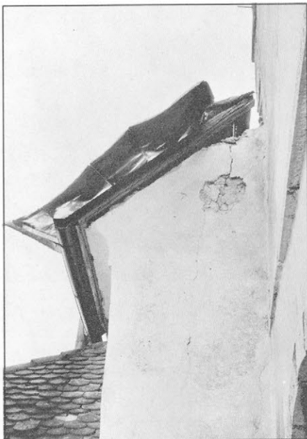
Slika 7. Na zadnjem delu cerkve je odtrgalo celotno pločevinasto kritino. Vidimo tudi navpično razpoko, ki poteka po celotni zunanji steni cerkve (foto R. Vidrih).
