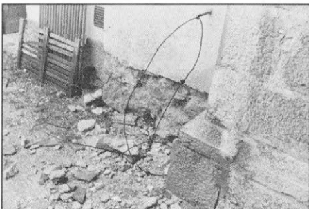
Slika 4. Poškodbe na zunanjih stenah, predvsem odpadanje ometa. Na objektu je bila pretrgana večina raznih napeljav (foto UNZ Ljubljana mesto).
