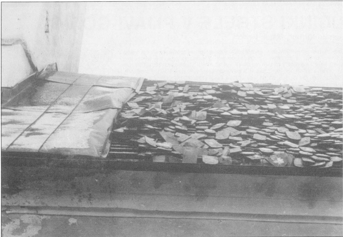
Slika 3. Poškodovana kritina strehe. Opeke je razmetalo po vsej strehi, večina jih je padla na tla in se razbila (foto UNZ Ljubljana mesto).
