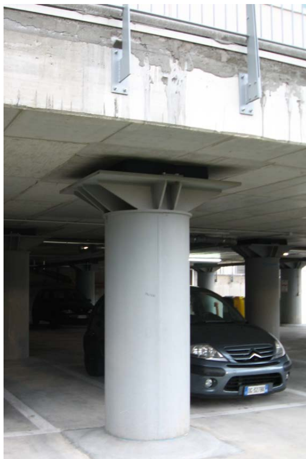
Slika 6: Krogelni potresni izolatorji so med vrhom AB-stebr in AB-ploščo stanovanjskega dela stavbe in so nameščeni v skledasti nosilec (foto: J. Jeraj, november 2010.)
