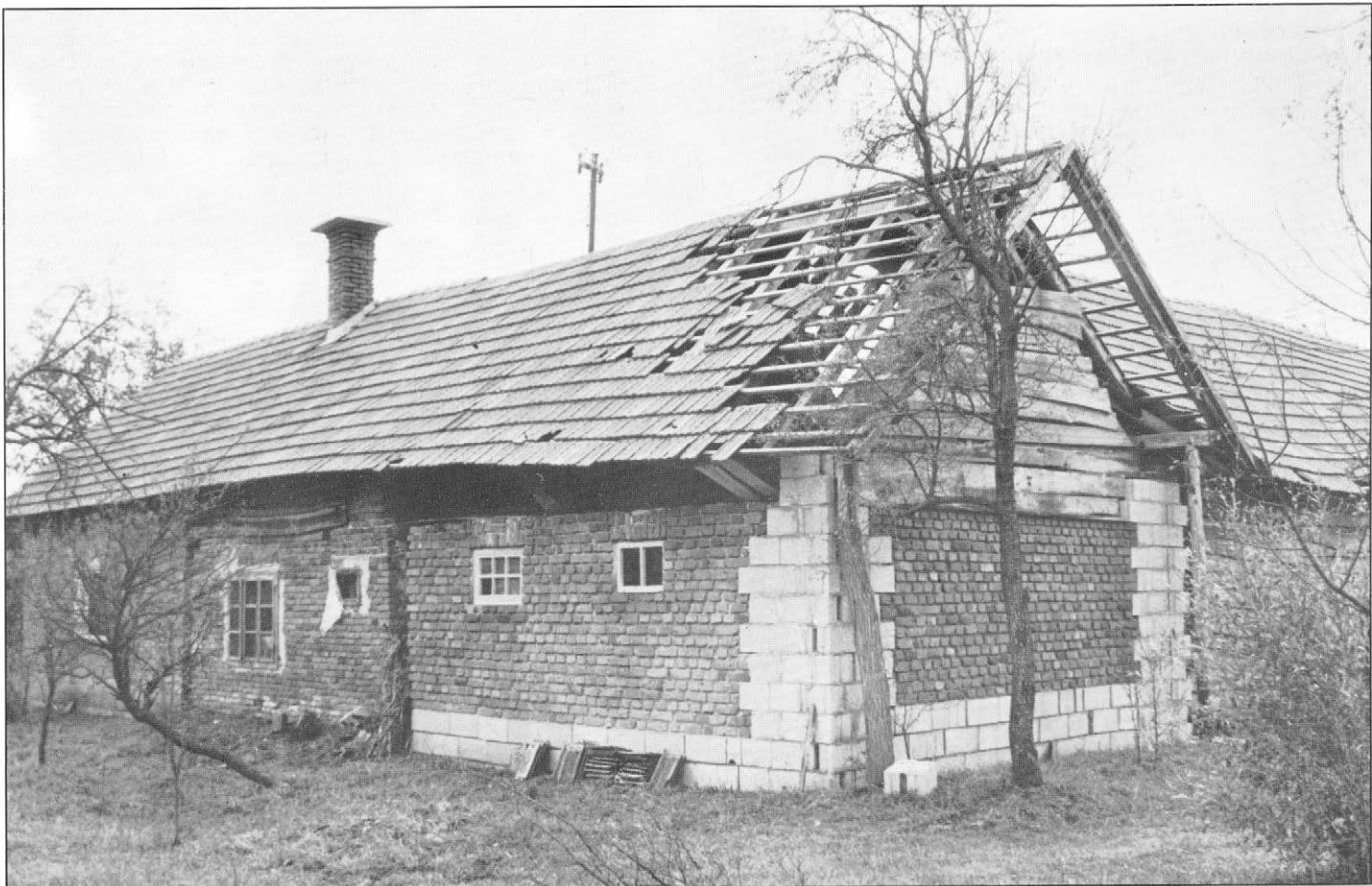
Poškodovana streha hiše v Gerlincih.
