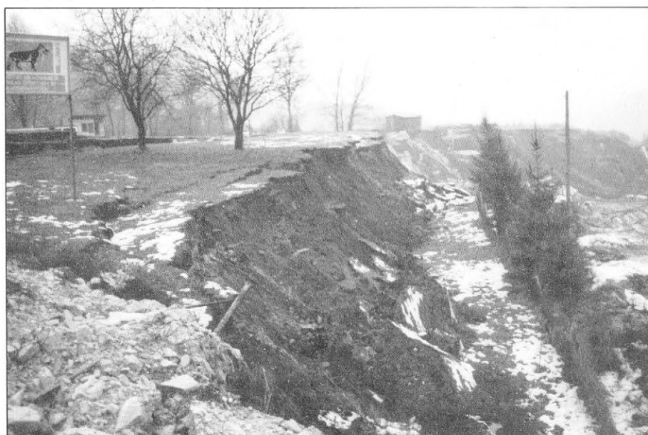
Strmi odlomi na platoju odlagališča.
