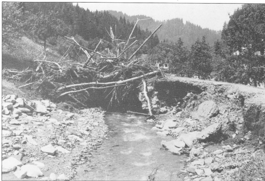
Slika 8. Zamašitev mostnega propusta po poplavljenem vejevju in dračju.
