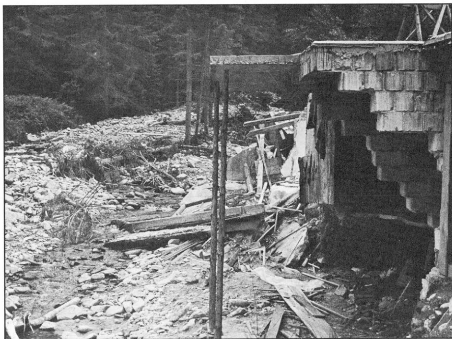
Slika 2. Izpodkopana hiša (Binčevo) v grapi Velke v Ribnici. Sredi slike ob neurju nastali prodni vršaj, na katerem je potok bočno erodiral in izpodkopal hišne temelje.
