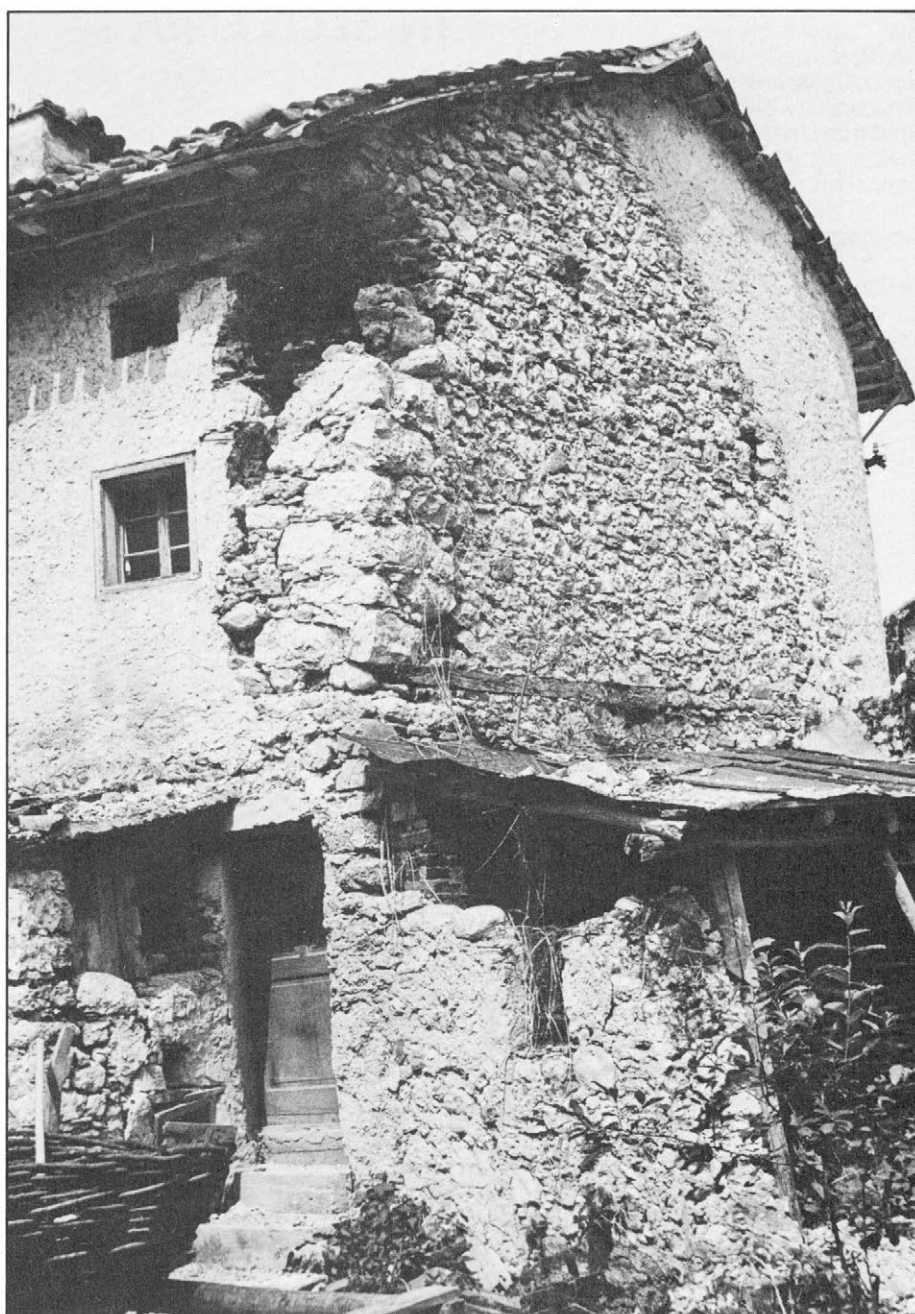
Slika 1. Tipična potresno poškodovana stara hiša v vasi Smast (rušenje vogala).
