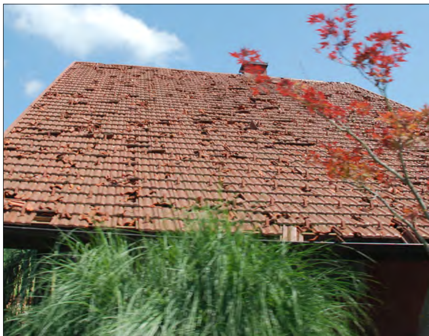
Slika 4: Poškodovana novejša strešna kritina v naselju Svibnik (foto: arhiv GZ Črnomelj)
