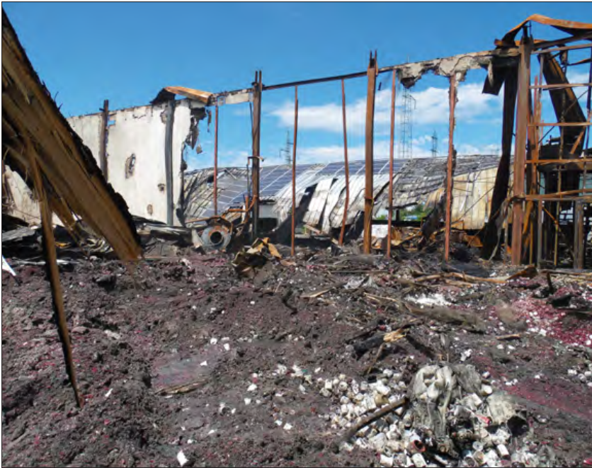
Slika 10: Pogašeno požarišče. Objekt je popolnoma pogorel. Vidni so sloji drobljene plastike, parafina in baterij. V sredini je delno porušena predelna stena, na porušeni strehi so ostanki še vedno delujočih panelov sončne elektrarne. V ozadju visokonapetostni električni daljnovodi (foto: B. Novak)
