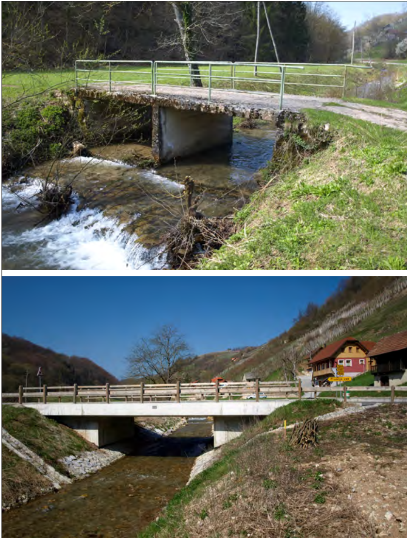
Slika 10: Primer starega mostu z neprimernim prepustom (zgoraj) in novejšega mostu (spodaj) (foto: J. Tičar)
