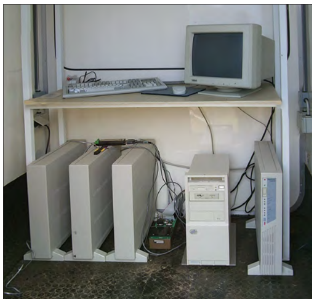
Slika 3: Oprema Nanometrics: osebni računalnik z vgrajenim sprejemnikom GPS, enota FEP in UPS z dodatnimi baterijami
