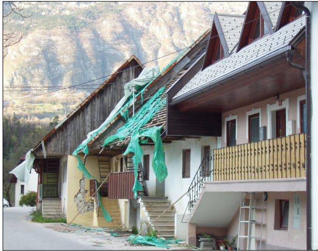
Slika 1: Mehki sedimenti, na katerih je zgrajena večina objektov, lahko izrazito vplivajo na povečanje potresnega nihanja tal in ob potresu povzročijo večje poškodbe, kot bi jih utrpel enak objekt, zgrajen na trdni geološki podlagi. Čezsoča po potresu leta 1998 (foto: A. Gosar).
