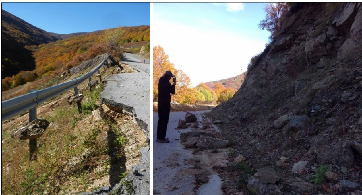
Slika 4: Primer plazov in skalnega podora na cesti med Drosopigi in Vitsi (foto: M. Jemec Auflič).
