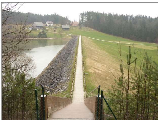
Slika 1: Pogled z desnega boka na krono pregrade Loče. Dolvodna stran telesa pregrade ne kaže površinskih znakov morebitnega puščanja. (foto: A. Širca)
