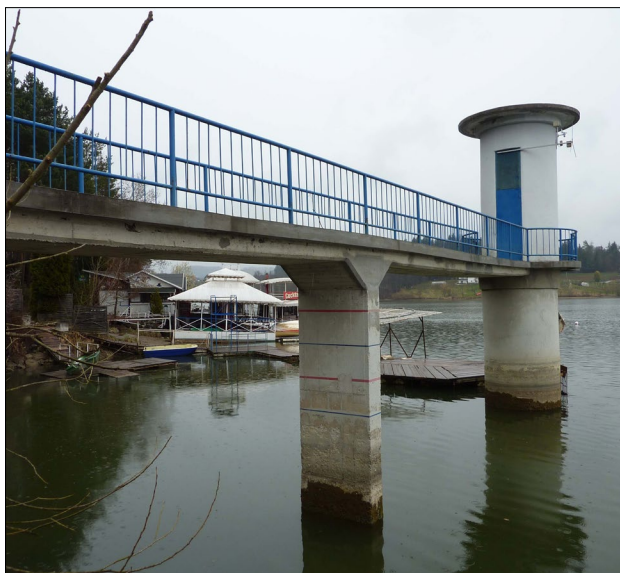
Slika 4: Odzemni objekt je treba sanirati še v delu, ki je trajno potopljen (pod koto 263,50). Sedanji objekt je težko vzdrževati, ker je zelo visok (15 m) in ozek (2 m). (foto: A. Širca)
