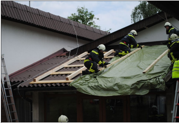
Slika 5: Prekrivanje uničene strešne kritine s plastično folijo. (foto: B. Kuntarič) Figure 5: Firefighters covering the damaged roof sheets with plastic foil. (Photo: B. Kuntarič)
