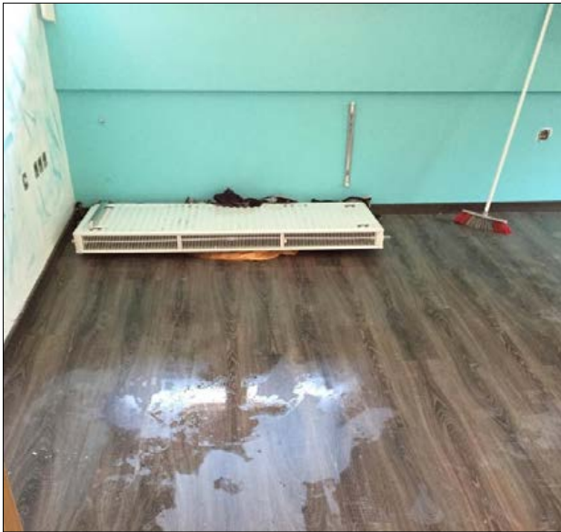
Slika 3: V novejši hiši na Vinjem Vrhu je z nosilcev odtrgalo radiator. (foto: J. Kodrič) Figure 3: A detached radiator in a new house at Vinji Vrh (Photo J. Kodrič).
