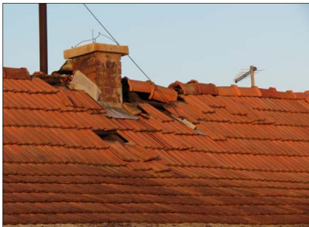
Slika 8: Poškodovani strešniki na Stojanskem Vrh (foto M. Godec) Figure 8: Damaged roof tiles in Stojanski vrh (Photo M. Godec).
