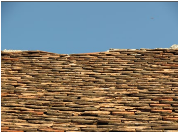
Slika 4: Odpadli slemenski strešniki v Tomšičevi ulici v Postojni (foto: M. Godec)
