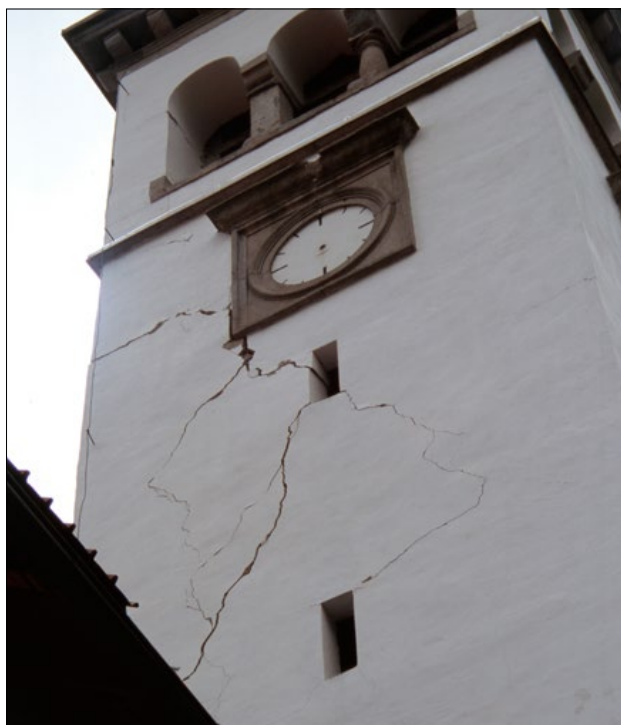
Slika 3: Ob potresu v Zgornjem Posočju 12. julija 2004 je bil poškodovan zvonik cerkve svetega Antona Puščavnika v Čezsoči. (foto: M. Zorn)
