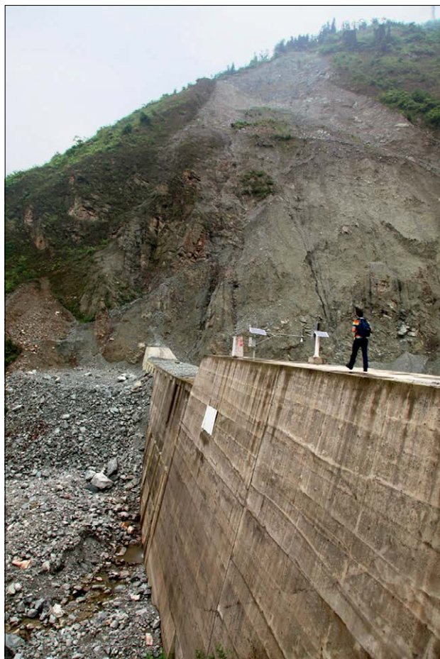
Slika 5: Masivna betonska hudourniška pregrada za umirjanje drobirskih tokov v strugi hudournika Hongchun v bližini mesta Yingxiu v provinci Sečuan na jugozahodnem delu Kitajske (foto: M. Mikoš, junij 2014).
