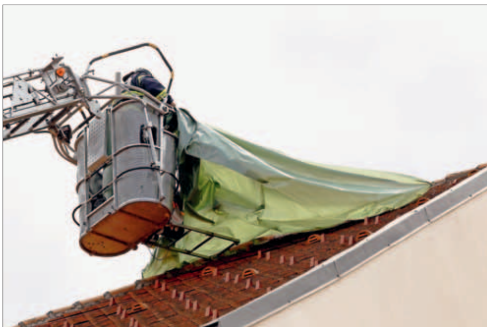
Slika 7: Sledilo je odstranjevanje posledic neurja, predvsem pokrivanje streh s plastično folijo. (foto: B. Toič) Figure 7: The disaster relief; the covering of roofs with plastic foil. (photo: B. Toič)
