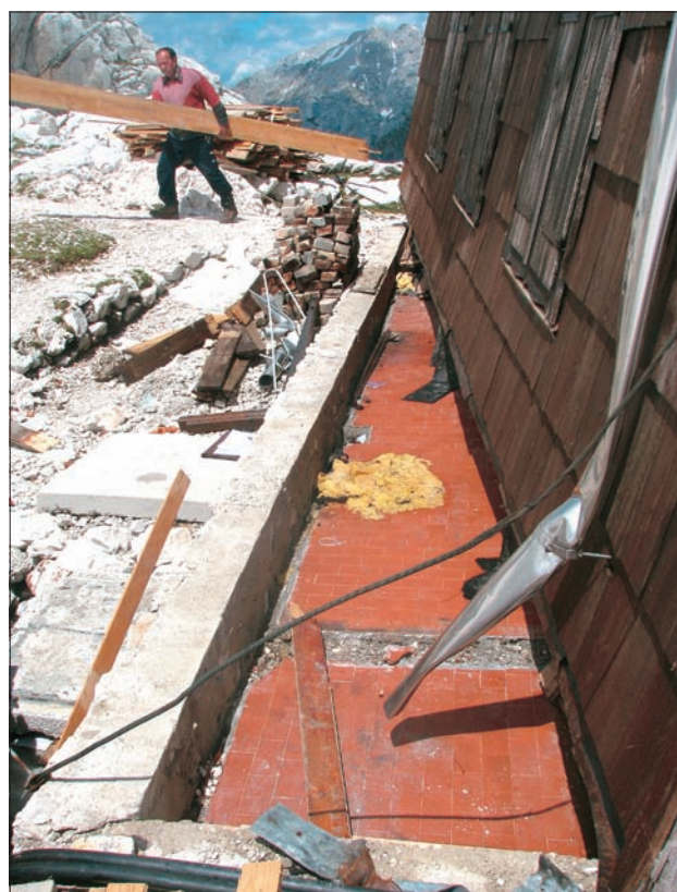
Slika 7: Premik in nagib zahodne fasade (foto: M. Pavšek)
