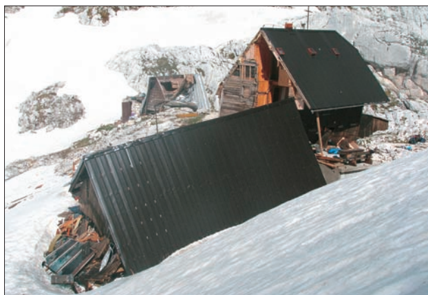
Slika 3: Porušeni koči na Doliču in bližnja zimska soba (v ozadju) ob ogledu 12. 6. 2009 (foto: M. Pavšek)
