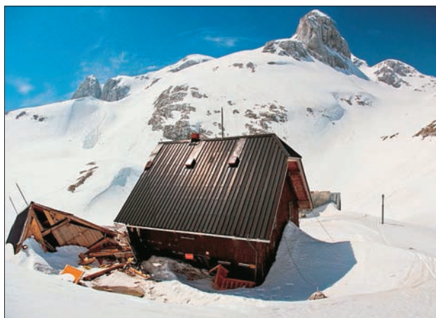
Slika 5: Poškodovana koči s severovzhoda konec aprila 2009 s Kanjavčevim čopom zadaj na desni (foto: F. Pogačar)
