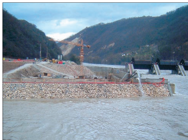
Slika 10: Sava je poplavlila tudi gradbišče HE Krško. (foto: arhiv URSZR)
