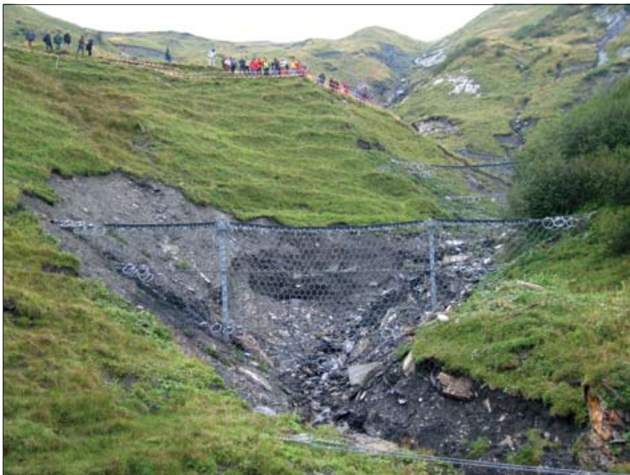
Slika 3. Razvoj na področju zaščite pred hudourniški izbruhi na težko dostopnem terenu – primer sistema prečnih, delno podajnih zaplavnih objektov, iz globoko sidranih posebnih jeklenih mrež z vgrajenimi absorpcijskimi deli, objekt v Švici, Meiringen, izveden 2008 (foto: PUH)
