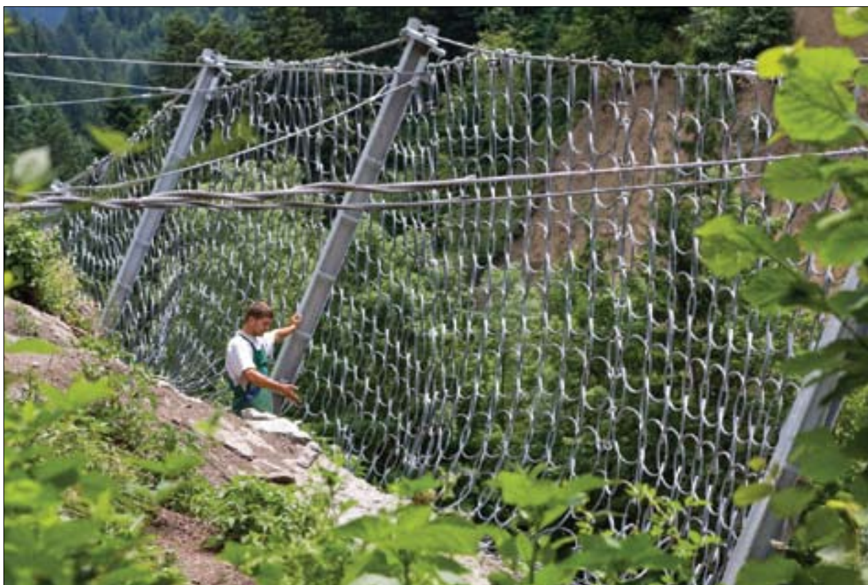
Slika 4. Na področju varstva pred padajočim kamenjem in snežnimi plazovi je bil v zadnjih petnajstih letih v Sloveniji narejen znaten napredek. Na sliki je primer sodobne lovilne podajne ograje (Luče) za zaščito pred padajočim kamenjem (foto: PUH)
