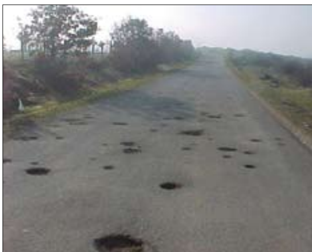
Slika 9. Poškodba asfaltnega cestišča po uporabi kasetnic, Kosovo, okolica Djakovice 2000 (foto: M. Bizjak)
