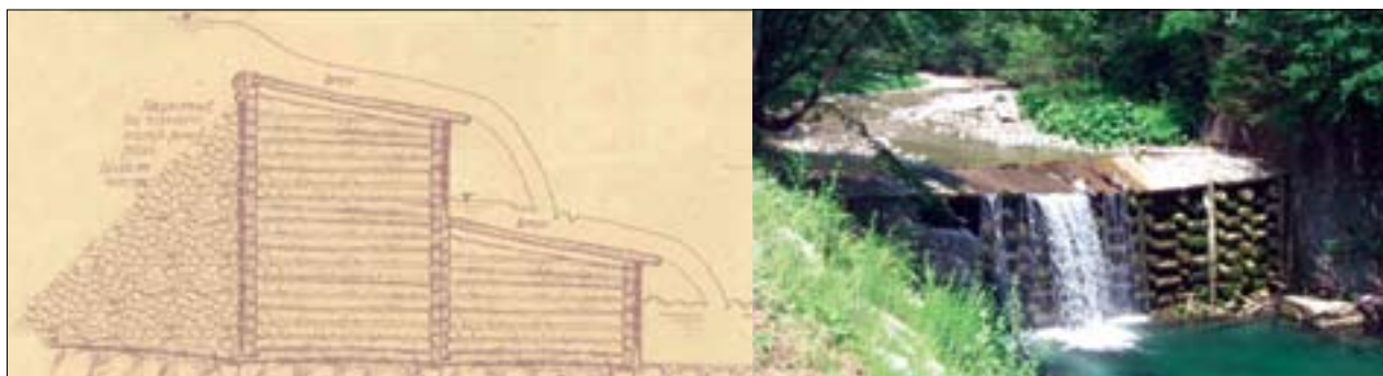
Slika 3. Shematski prikaz dvostopenjskega kaštnega jezua. Desna fotografija enostopenjskega jezua prikazuje značilno poškodbo krova kaštnega jezua (prehod proda, trohnenje), kar zahteva redno vzdrževanje. (foto: T. Markič)
