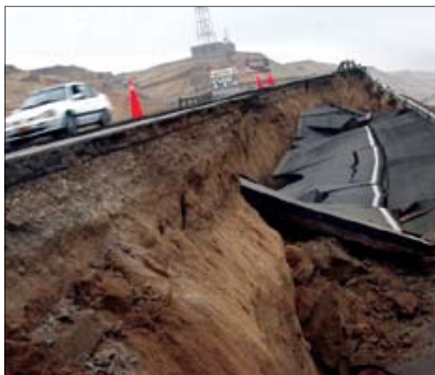
Slika 5. Delna porušitev cestišča na obalni cesti panamerika v okolici nadžarišča.
