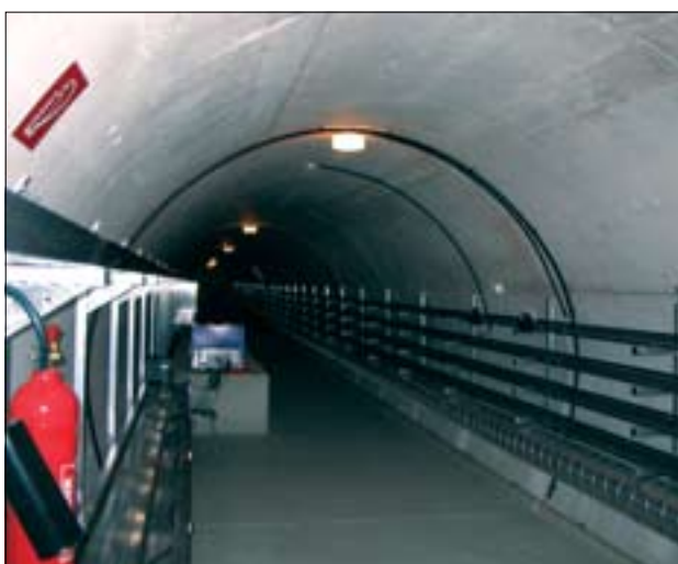
Slika 7. Lokacija preskusnega sistema v predoru.
