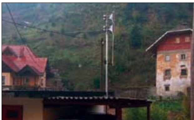
Slika 3. Elektronska sirena na lokaciji garaže Figure 3. Electronic siren at the Garaže site
