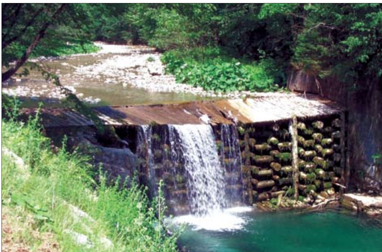
Slika 4. Poškodovana pregrada iz lesene kašte (hudournik Kokra) Figure 4. Damaged wooden crib dam (Kokra Flood)
