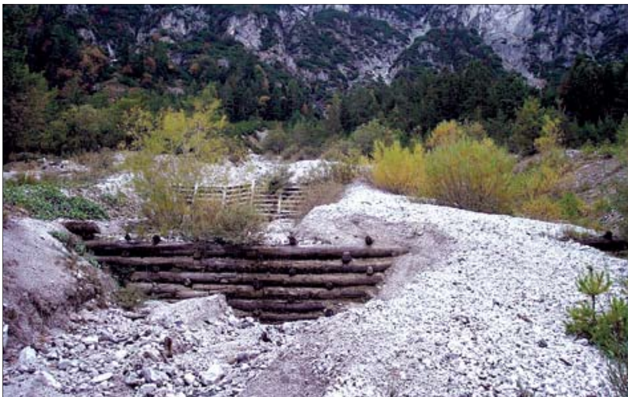
Slika 6. Poškodovani ustaljitveni objekti – lesena kašta in armiranobetonska kašta (Dovški potok)
