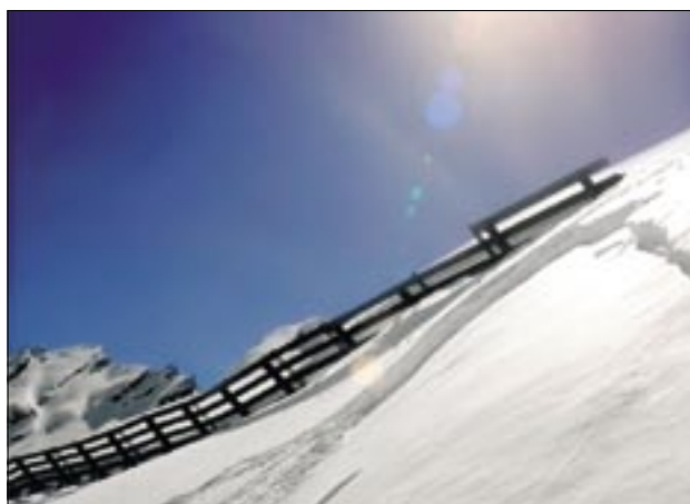
Slika 2. Protilavinski objekti v območju utrganja snežnega plaz: celo pri najsoodnejših varovalnih ukrepih je treba opozarjati na t. i. preostalo tveganje.
