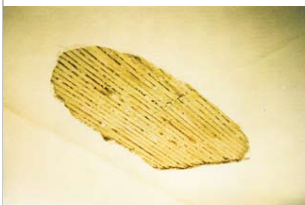
Slika 6. Odpadanje velikih kosov ometa s stropa gasilskega doma v Ilirski Bistrici, Titov trg 11 (potres 1995).
