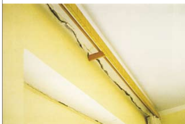
Slika 7. Globoke razpoke na stiku zidu in stropne konstrukcije v stanovanjski hiši v Ilirski Bistrici, Župančičeva 1 (potres 1995).
