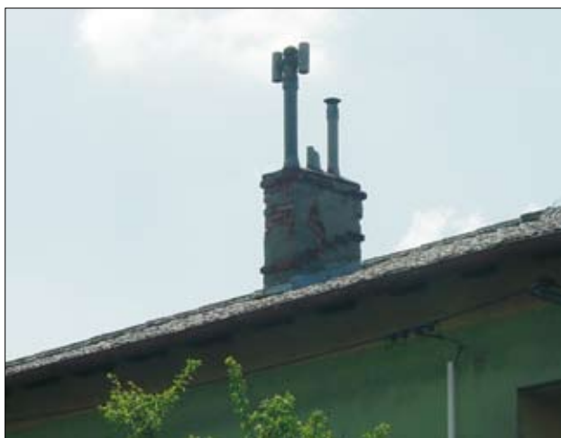
Slika 11. Ob potresih so pogosto najprej poškodovani dimniki. Vidimo primer poškodovanega dimnika na Gubičevi 1a v Ilirski Bistrici.
