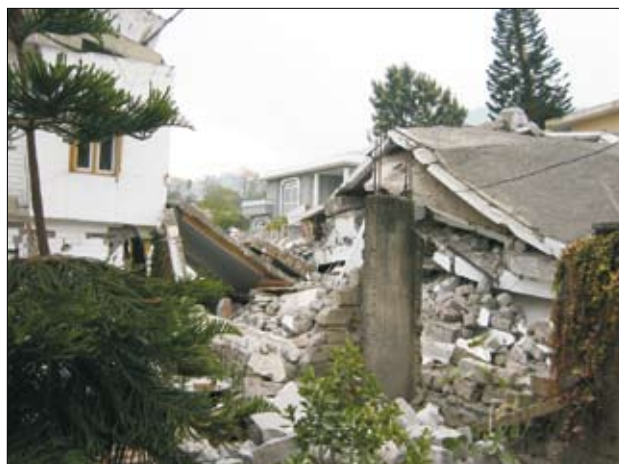
Slika 10. Muzaffarabad: v ospredju porušena hiša iz betonskih blokov, v ozadju nepoškodovana hiša iz opeke in levo močno poškodovana hiša iz kamnitih blokov.
