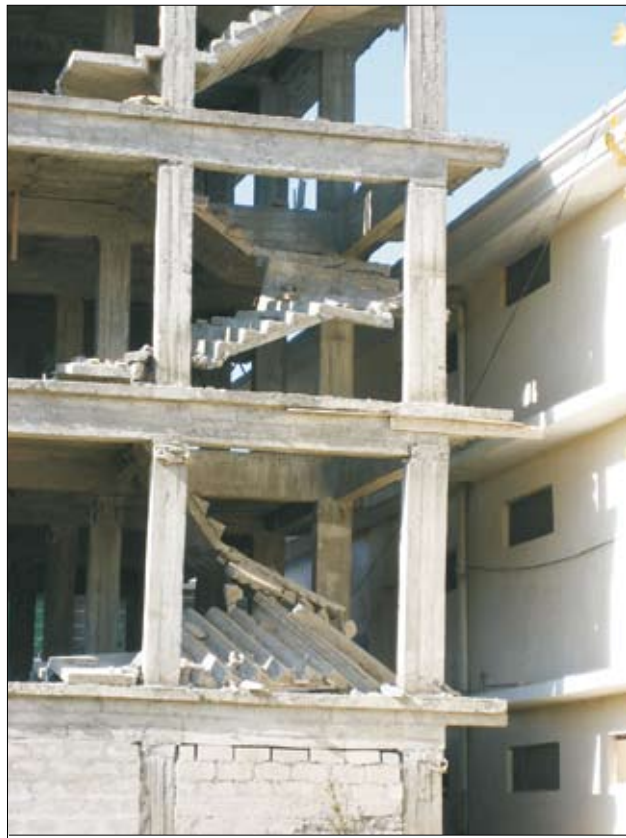
Sliki 14. Detajl poškodb stopnišča v vogalu.
