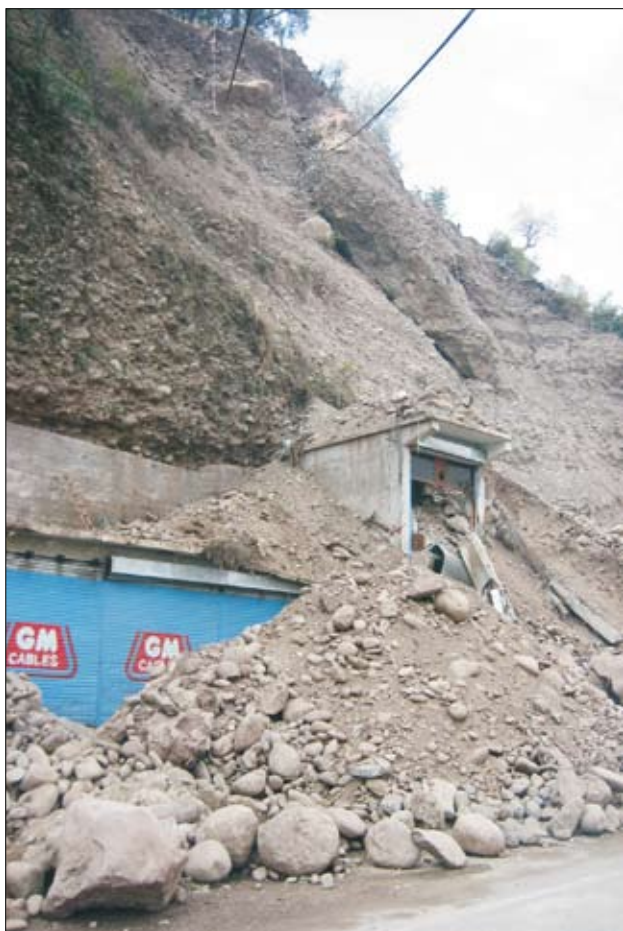
Slika 24. Muzaffarabad: strma pobočja, ki so jih v ledeniške nanose izdolble reke, so nestabilna. Številni zdrsi in podori so zasuli ceste in pod seboj pokopali stavbe.
