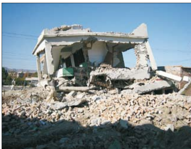
Slika 11. Abbotabad: ostanki armiranobetonske stavbe z zidanimi opečnimi polnili.
