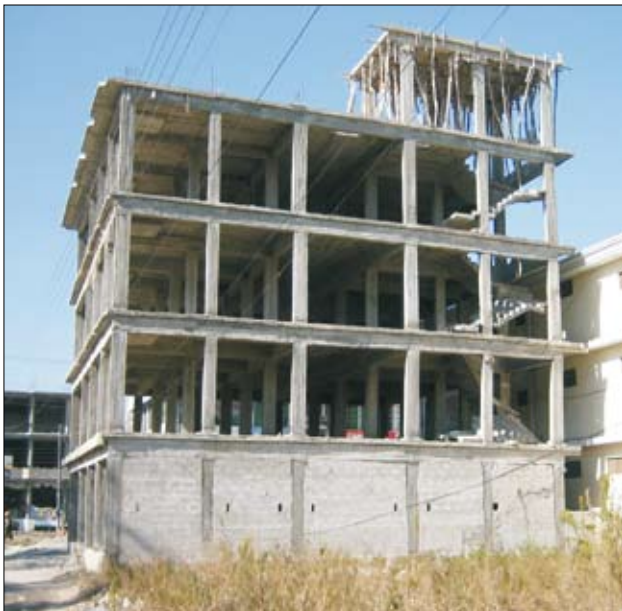
Slike 12. Abbotabad: nedokončana armiranobetonska okvirna konstrukcija z zidanimi polnili. Zidana polnila v pritličju so območje poškodb preselila v prvo nadstropje. V eni smeri šibki stebri in stopnišče v enem od vogalov so povzročili nastanek plastičnih členkov v stebrih nad pritličjem, velike preostale deformacije zgornjega dela konstrukcije, zasuk konstrukcije zaradi torzijskih vplivov in hude poškodbe stopnišča.
