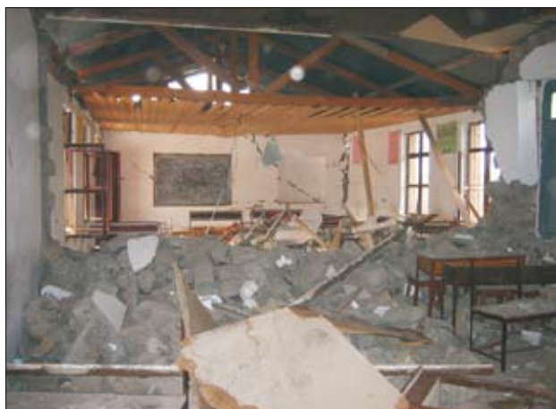
Sliki 20. Na poti v Muzaffarabad: lesena strešna konstrukcija šole, porušeni prečni zid in močno poškodovano obodno zidovje.
