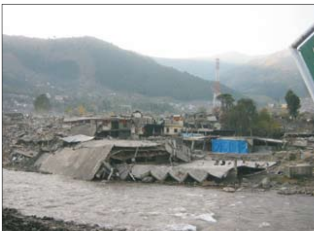
Slika 18. Balakot: porušena armiranobetonska konstrukcija hotela (medetažne konstrukcije so zložene kot palačinke).
