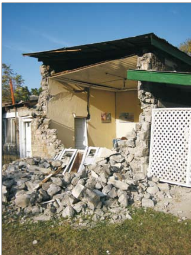
Slika 9. Balakot: zidovi niso povezani z vezmi. Porušitev kamnitega zidu zaradi nihanja pravokotno na ravnino.
