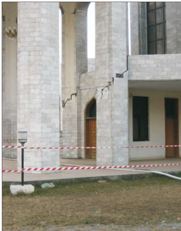
Slika 21. Muzaffarabad: palača vrhovnega sodišča. Strižne poškodbe neustrezno zasnovanih stebrov.
