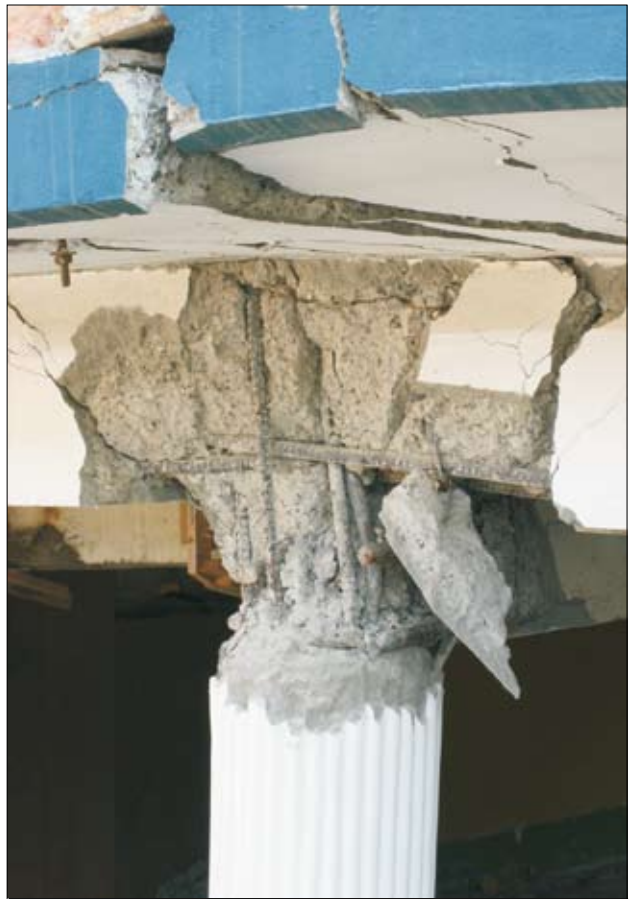
Slike 15. Abbotabad: detajli poškodb porušene armiranobetonske konstrukcije – neustrezno položena armatura vozlišča.
