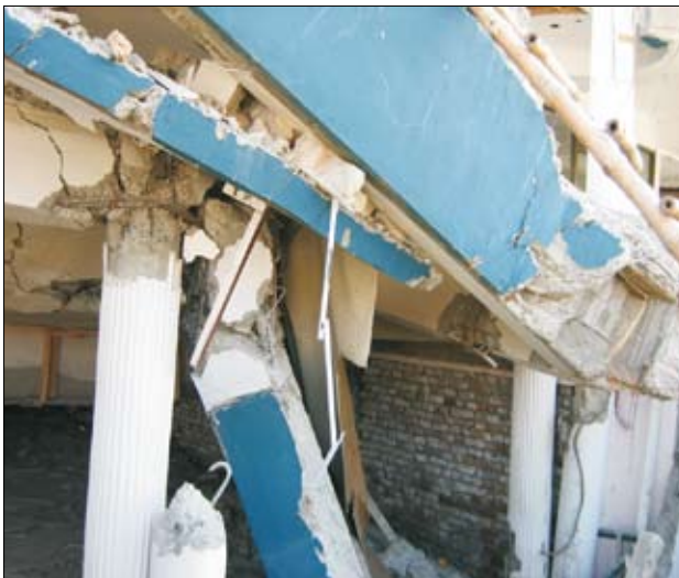
Slika 16. Abbotabad: detajli poškodb porušene armiranobetonske konstrukcije – plastični členki v stebrih in porušena medetažna konstrukcija.
