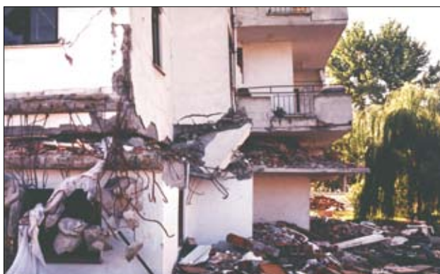
Slika 7. Poškodbe na ožjem nadžariščnem območju ob potresu z magnitudo 7,4 (potres 17. avgusta 1999 v Turčiji)
