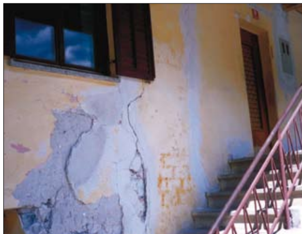
Slika 4. Poškodbe na ožjem nadžariščnem območju ob potresu z magnitudo 4,9 (potres v Zgornjem Posočju 12. junija 2004)
