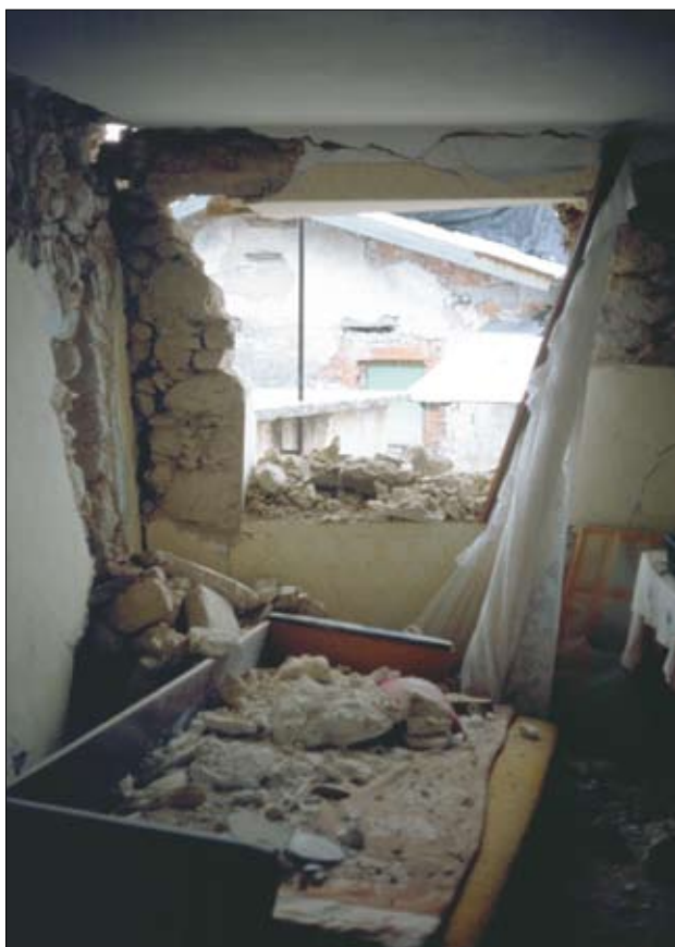
Slika 5. Poškodbe na ožjem nadžariščnem območju ob potresu z magnitudo 5,6 (potres v Zgornjem Posočju 12. aprila 1998)
