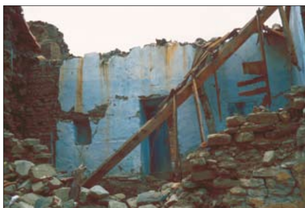
Slika 6. Poškodbe ob potresu na ožjem nadžariščnem območju z magnitudo 6,8 (potres 21. maja 2003 v Alžiriji)
