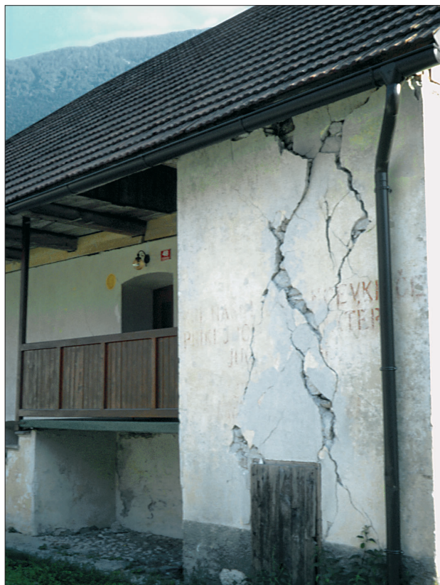
Slika 14. Zaradi slabih seizmogeoloških razmer so bili učinki potresa v nekaterih predelih za celo stopnjo višji. Nekatere zgradbe v Čezsoči je bilo treba podreti.
