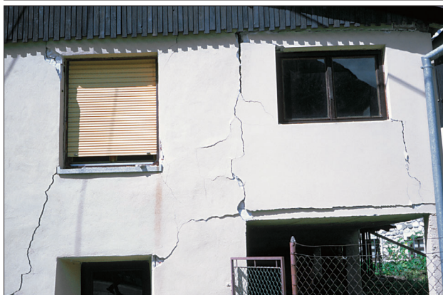
Slika 12. Močno poškodovana hiša v Čezsoči kaže neprimerno dozidavo prizidka.
