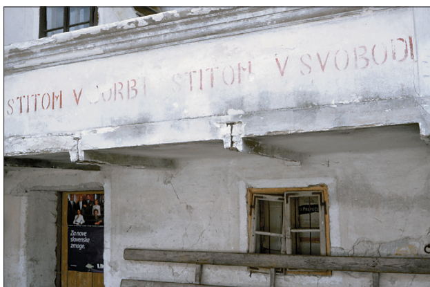
Slika 9. Globoke razpoke v starejših slabo grajenih zgradbah Figure 9. Deep cracks in older, badly constructed buildings
