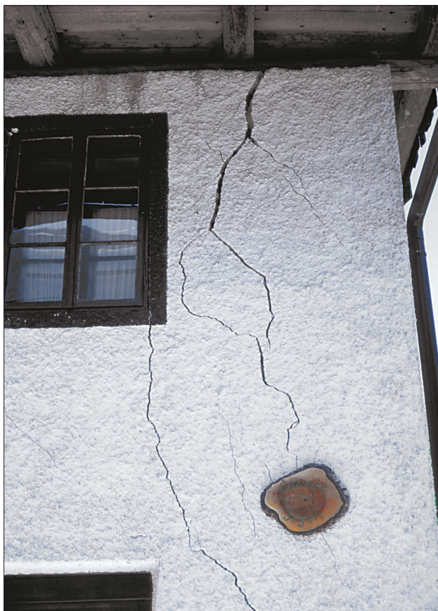
Slika 7. Močno poškodovana hiša v Čezsoči Figure 7. Severely damaged house in Čezsoča
