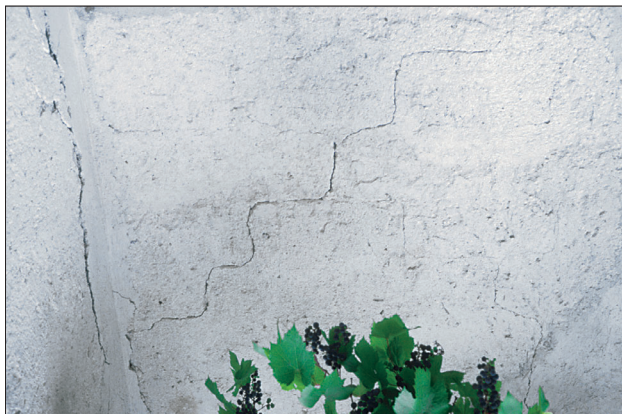
Slika 13. Razpoke na starejši zgradbi v Čezsoči
