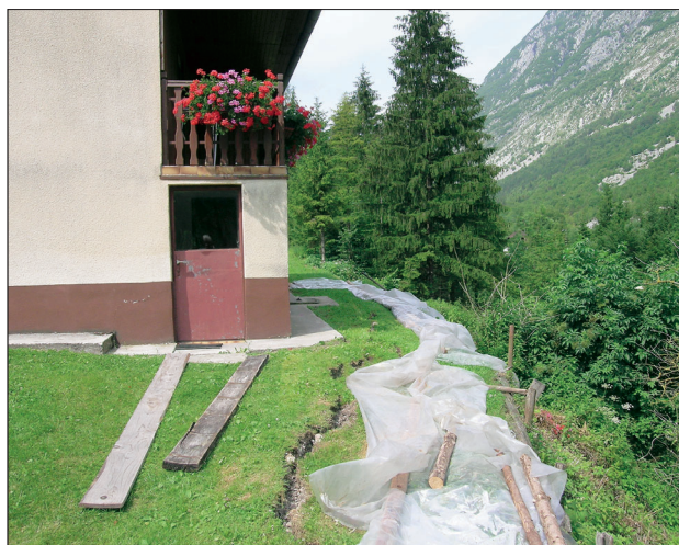
Slika 3. Pogoste poškodbe so bile tudi dolge razpoke, ki so nastajale ob robovih teras. Primer na sliki je iz vasi Soča, na levem bregu Soče. (foto: R. Vidrih)
