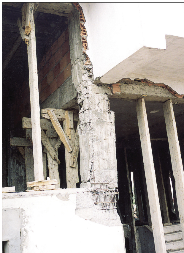
Slika 16. Zemmouri – Veliko stebrov je bilo slabo zgrajenih. Na tem kratkem stebriu je prišlo do poškodb zaradi pomanjkanja stremenske armature. Ponekod so pri izdelavi betona uporabljali tudi slano vodo (foto: M. Godec).
