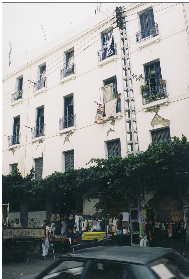
Slika 17. Alžir – Objekti so bili poškodovani tudi v glavnem mestu, kljub temu da je od žarišča oddaljeno več kot 50 km. Tipična stanovanjska hiša iz francoskega kolonialnega obdobja z značilnimi strižnimi razpokami (foto: M. Godec).
