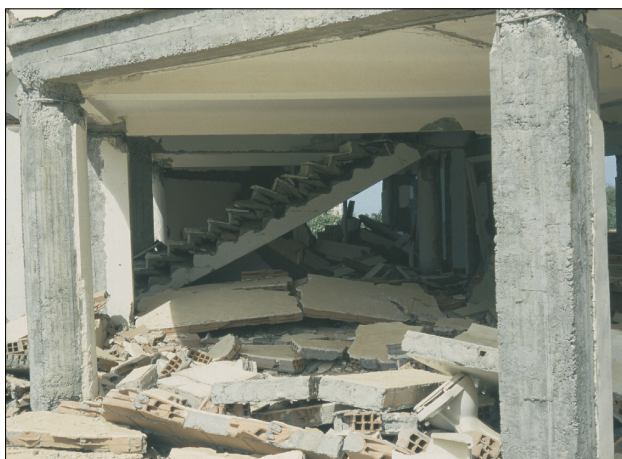
Slika 8. Boumerdes – Pogled v notranjost poškodovanega objekta (porušene predelne stene, lom stebrov v vozliščih). Prečke so močnejše od stebrov, kar vodi v nevarne poškodbe stebrov. Konstrukcije, kjer pride do plastifikacije prečk, so varnejše od tistih, kjer pride do plastifikacije stebrov (foto: R. Vidrih).
