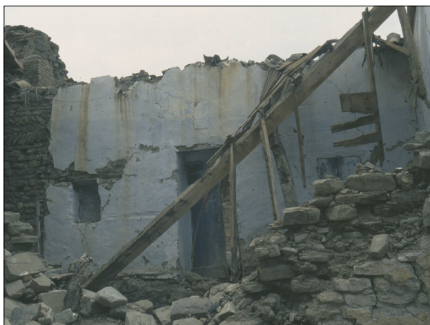
Slika 20. Dyllisse. – Zaradi porušenega zidu se je porušila še streha. Pri takih zgradbah je osnovna napaka nepovezanost zidov (foto: R. Vidrih).
