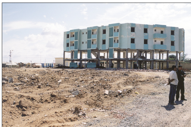
Slika 13. Zemmouri – V novešem delu so bile poškodbe tudi na še neveljenem objektu. Žal je bil popolnoma enak objekt med potresom popolnoma uničen (že odstranjen). Načrt je bil popolnoma enak, talni pogoji skoraj enaki, izvajalec pa drug (foto: M. Godec).
