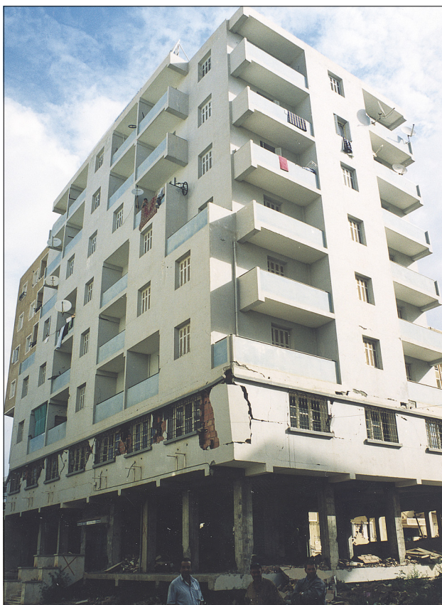
Slika 15. Zemmouri – V novejšem stanovanjskem bloku je prišlo do poškodb zaradi »mehkega« pritličja. Stebri v pritličju so bili poškodovani, predelne stene so bile porušene (foto: M. Godec).
