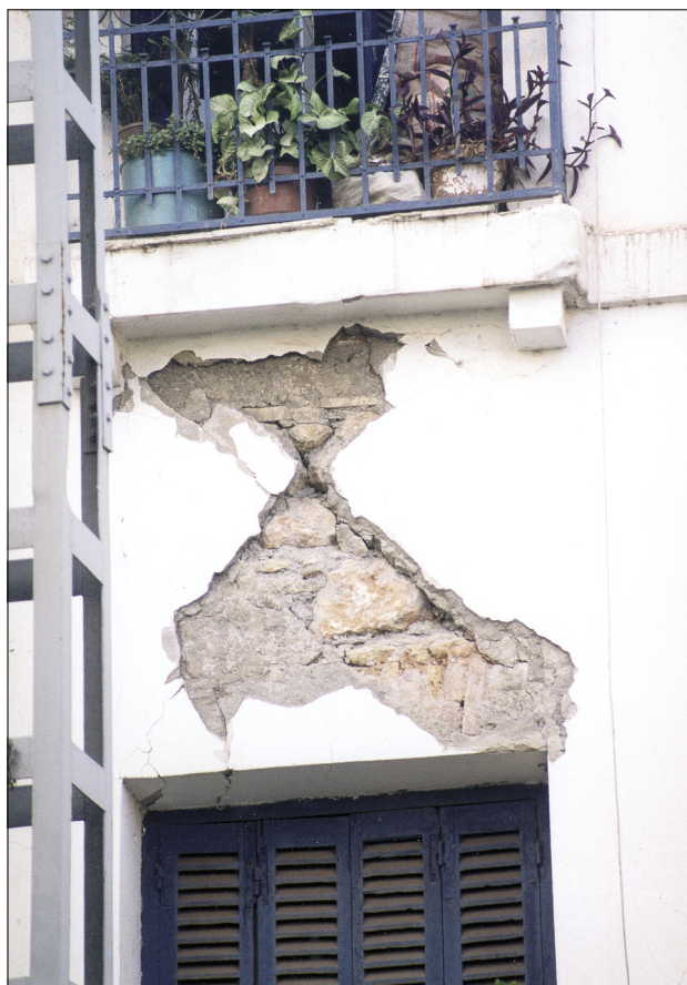
Slika 18. Alžir – Detajl strižne razpoke, kjer se vidi zgradba zidu (obdelan in neobdelan kamen v malti vprašljive kakovosti) (foto: M. Godec).
