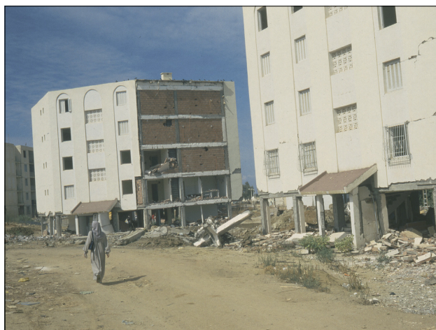
Slika 6. Boumerdes – Novejše stanovanjsko naselje, kjer je do porušitev prišlo zaradi mehkih pritličij (foto: R. Vidrih).
