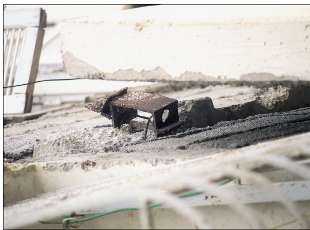
Slika 9. Boumerdes – Vzrok odpadanja elementov je bilo prerjavenje vijakov in podložk (foto: M. Godec).
