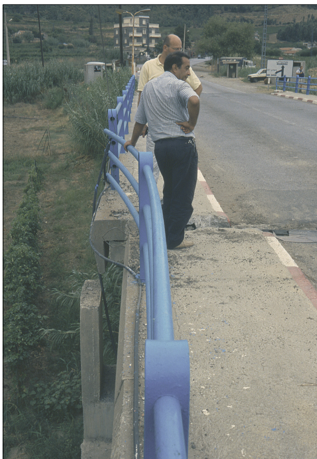
Slika 22. Alžir in Zemmouri – Poškodbe na mostu, ki so posledica slabih temeljnih tal (foto: R. Vidrih).
