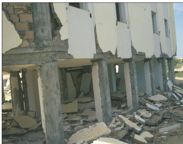
Slika 7. Boumerdes – Detajl mehkega pritličja. Vzrok za porušitev je bila podajna in šibka etaža v togem zgornjem delu zgradbe. (foto: R. Vidrih).
