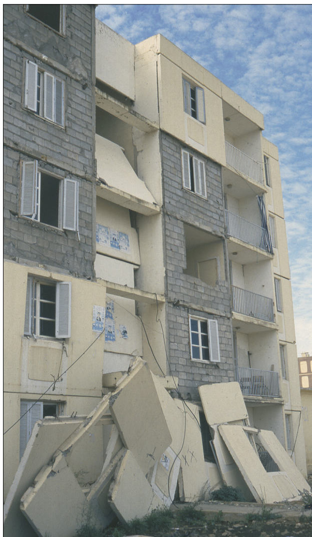
Slika 5. Boumerdes – Montažni fasadni elementi so med potresom odpadli (foto: R. Vidrih).
