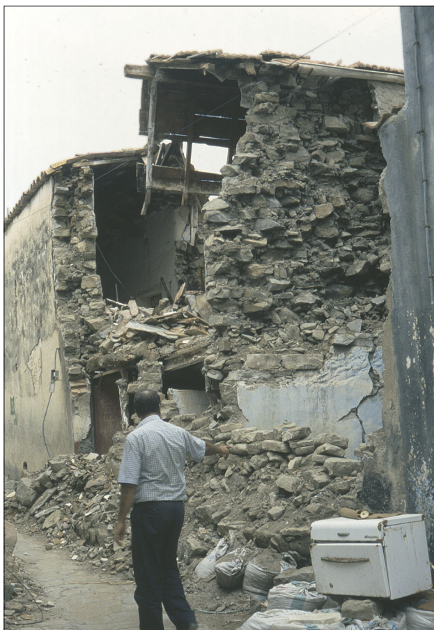
Slika 19. Dyllisse – Stari del mesta (Kazbah) je bil močno poškodovan. V takšnih zgradbah so poškodbe pričakovane (debeli, masivni zidovi iz obdelanega in neobdelanega kamna v slabi malti, včasih v blatu) [foto: R. Vidrih].
