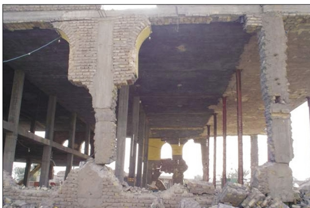
Slika 22. Bam. Polnila lahko bistveno spremenijo obnašanje konstrukcij. Pri zgradbi na sliki je prišlo do hudih poškod (lom stebra) na mestih tik nad parapetom.
