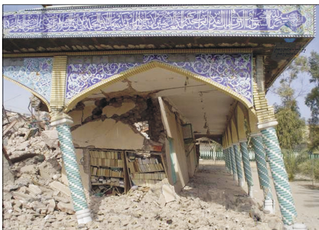
Slika 20. Bam. Tanki vitki stebri niso mogli prenesti velikih potresnih sil, ki so posledica masivnega strešnega dela.
