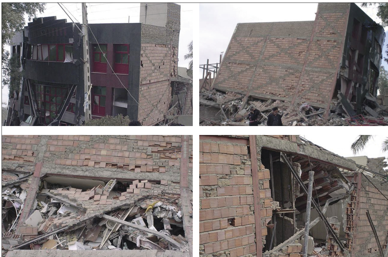
Slika 19. Bam. Tudi sodobneje zasnovani in grajeni objekti so bili med potresom uničeni. Na slikah a, b, c in d so poškodbe zgradbe, ki je okvir s polnili. Čeprav se zdi, da je zgradba nosilna, saj so polnila ojačana z diagonalami, je lahko do porušitve prišlo zaradi lokalnih geoloških razmer.
