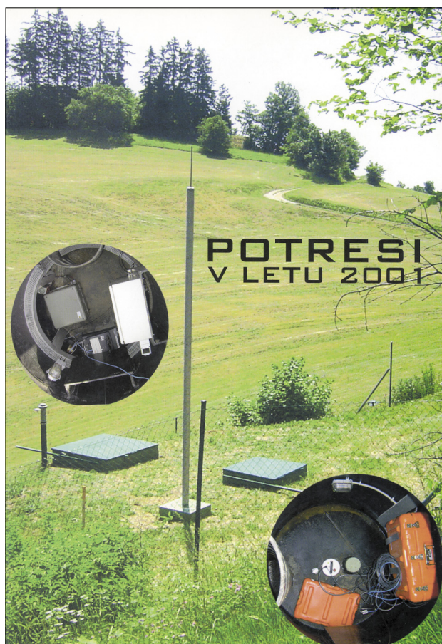
Slika 1. Naslovnica: Pogled na potresno opazovalnico Goliše na pobočju Orlice, najbolj severno ležečo v omrežju potresnih opazovalnic okoli jedrske elektrarne Krško. Levo je pomožni jašek z usmernikom in akumulatorjem za napajanje instrumentov ter za komunikacijsko opremo, ki jo sestavljata modem in usmerjevalnik. Desno je seizmični jašek s seizmometrom v 18 m globoki vrtini in z zajemalno napravo.
