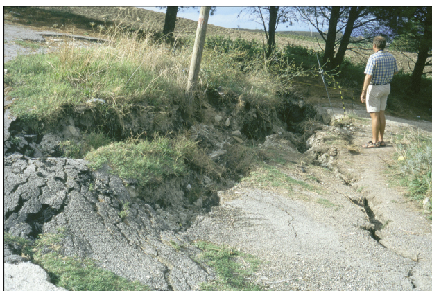
Slika 11. V nekaterih predelih se je cestišče pogreznilo za več metrov. V zgornjem delu plazu so bili vzdolžni premiki po pobočju največji, zaradi tega so bile tudi poškodbe največje (foto: R. Vidrih).
