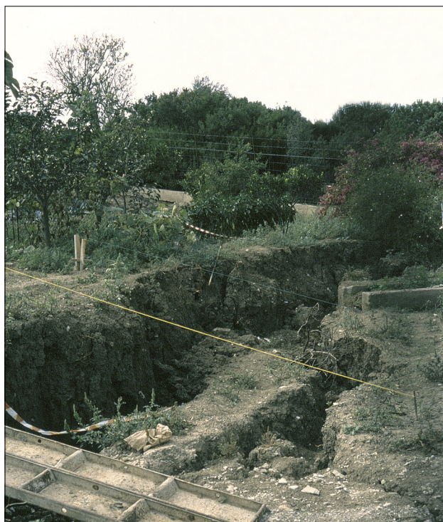
Slika 8. Sekundarni odlomni rob. Plazenje je zajelo tudi most, na srečo nobena zgradba ni bila poškodovana (foto: R. Vidrih).
