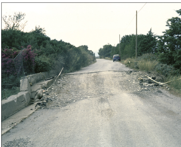
Slika 12. Plaz je premaknil betonski most za približno 20 cm, cestišče pa se je pogreznilo za približno pol metra (foto: R. Vidrih).
