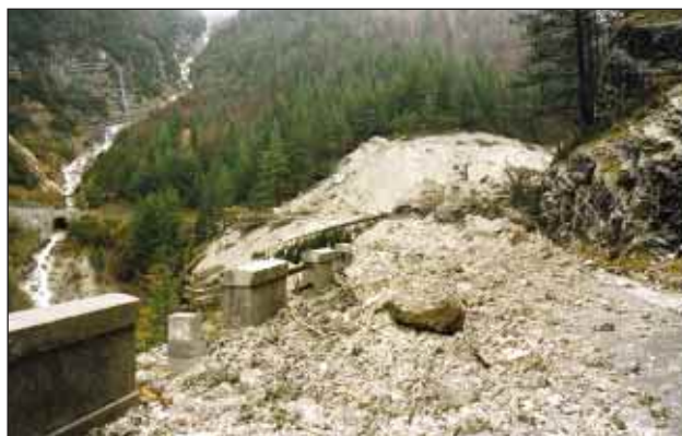
Slika 14. Porušeni most na cesti Log pod Mangartom–Predel po prvem drobirskem toku (foto: B. Ušeničnik) Figure 14. Demolished bridge on the Log pod Mangartom–Predel road after the first debris flow (photo: B. Ušeničnik)
